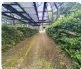
8.6: Voie d'évacuation accidentée
