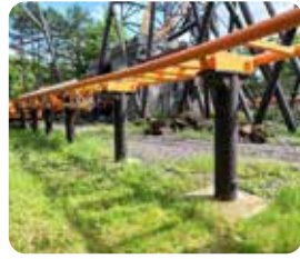
13.6: Voie d'évacuation irrégulière
